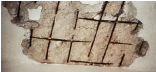
Kuva 10-14. Pintakerroksen irtoaminen rudoituksen yläpuolelta betoniteräksen korroosion vuoksi.
