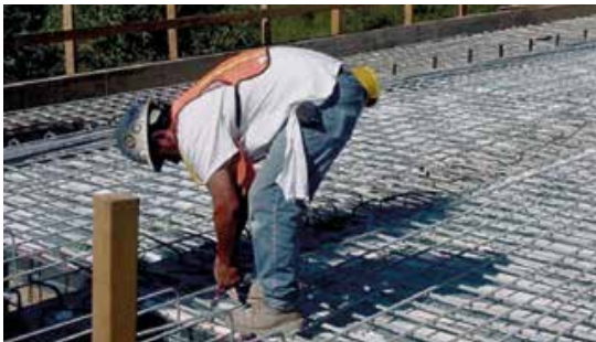
Kuva 10-15 Kuumasinkittyä rudoitusta sillassa.
