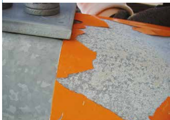
Kuva 11-4. Kosteus sinkissä aiheuttanut valkoruosteen syntymisen maalikalvon alla, maalaamattomalla pinnalla sinkin laatu on virheetön.
